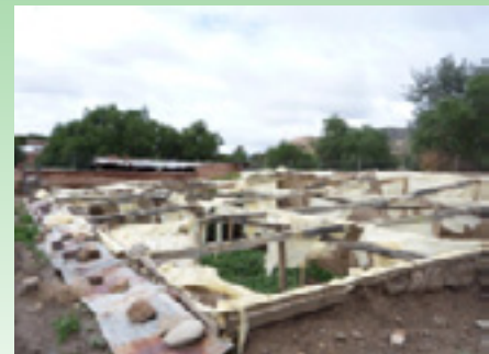
Bild1: Zerissene Dachfolien, jedes Jahr erneuert
